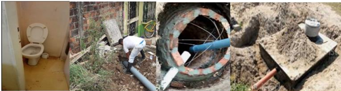
Excusado conectado a pozo ciego
